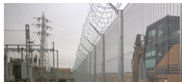
Bavolet Haro avant installation du réseau défensif
